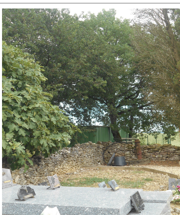
Le mur un peu plus loin, toujours longeant la parcelle AX56, a un grand besoin de restauration, il s'écroule c'est un mur typique de pierres sèches qui nécessite l'accès de chaque côté pour le restaurer et l'entretenir, mais il ne peut plus être approché par l'extérieur, les voisins ont barré l'accès. La restauration a été interrompue, les tombes ne sont plus à l'abri du mur.
