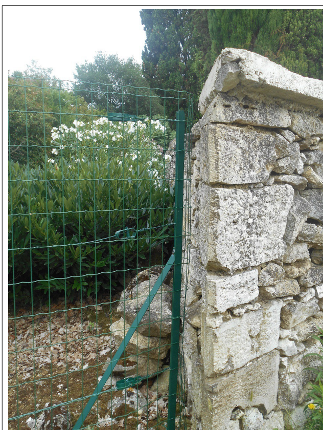
Les propriétaires ont bloqué tout accès au mur en plantant une seconde haie tout contre le mur qui devient inaccessible pour l'entretien. La mairie demande l'expropriation d'une bande de 3m soit 130 m 2 sur la parcelle AX56
